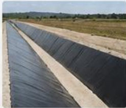
CANALISATIONS & RÉSEAUX D'IRRIGATION
